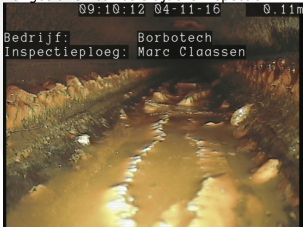
Aangetroffen corrosie tijdens inspectie
